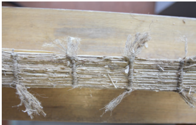
Foto 13 – Nivelul de degradare al nervurilor
